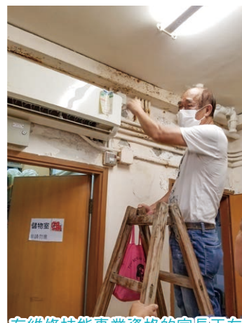
有維修技能專業資格的家長正在幫忙檢查樂聚內部的電力裝置
